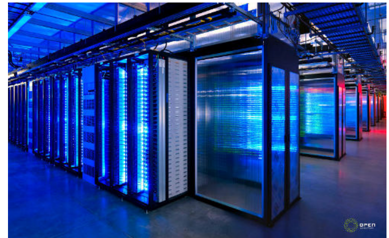
Rechenzentrum von Facebook in Pineville
